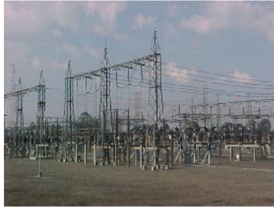
Figura 15 Pátio Manobra de 230 kV
