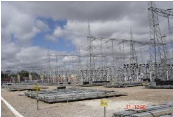
Figura – 3 Pátio subestação
