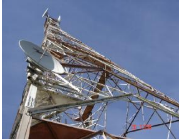
Figura – 12 Torre de microondas – 70 metros
