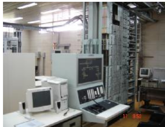
Figura – 11 Sala de Operação Telecomunicação
